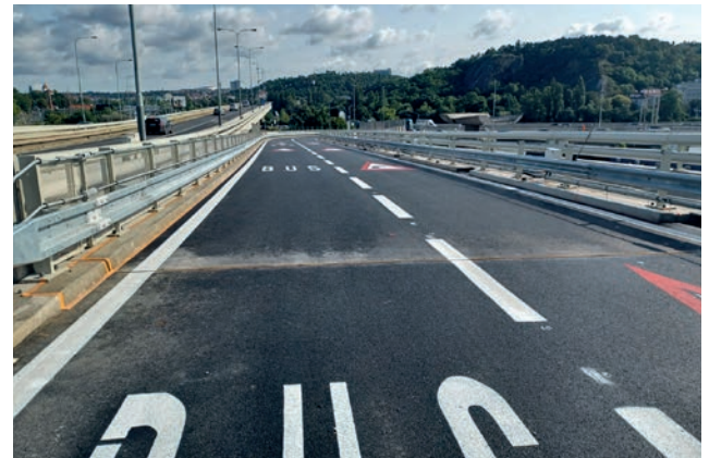
Svodidlo ZMS4/H3 (vlevo) na nájezdu na Barrandovský most od Plzně.
