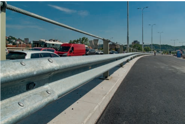
Svodidlo ZMS4-A3/H2 na jižním mostě Barrandovského přemostění.
