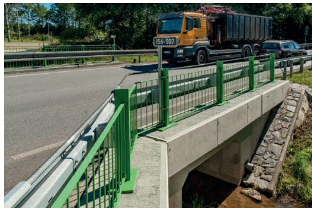
Svodidlo ZMS4-1/H2 na mostku 156-007 v Nové Vsi.
